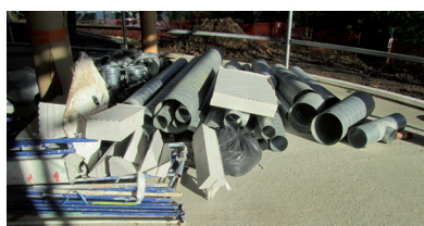
Stockage de gaines de ventilation et problématique d'empoussièremment
