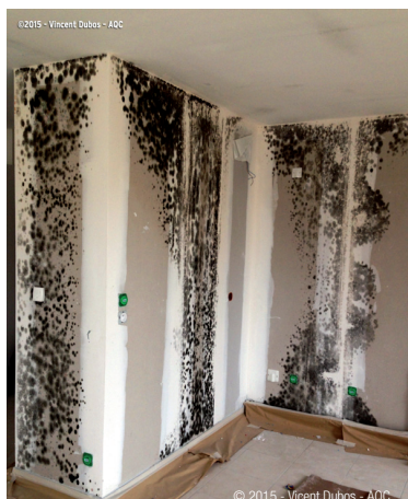
Développement de moisissures sur cloisons en phase chantier
